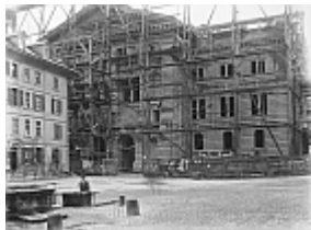
Façade nord en construction, vue de la place fédérale vers 1899 (l'immeuble à gauche et la fontaine ont été démolis par la suite)
